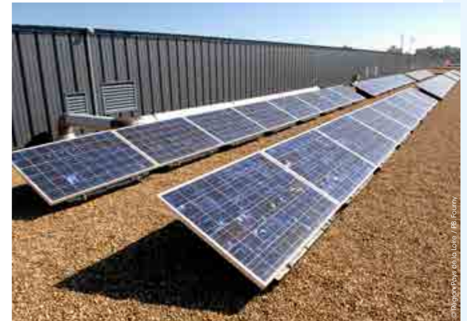
Lycée rénové avec installation de panneaux solaires à Angers (49)
