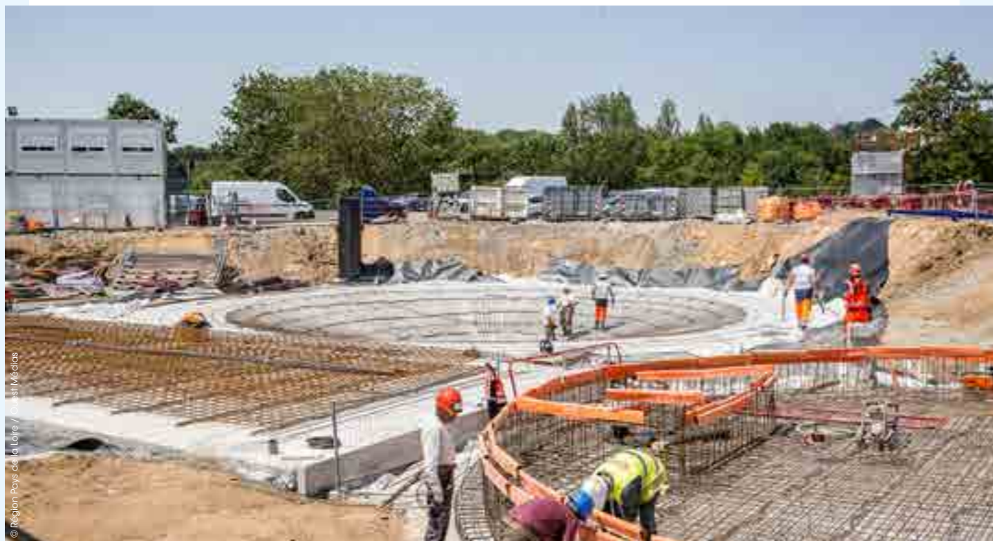
Unité de méthanisation à la station d'épuration de la Chauvinière (72)
