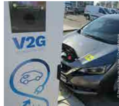
Nouvelles bornes de recharge électrique à Orvault (44)
